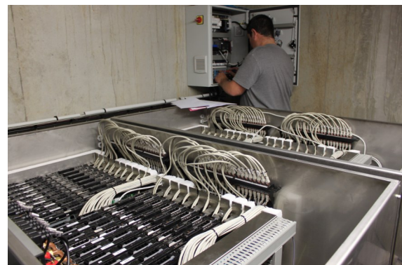
Des serveurs informatiques pour chauffer l'eau des locataires.
